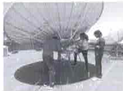
Cambio de cable "RF" a la antena receptora
