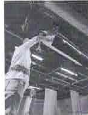
Limpieza de cortadoras de la iluminación
