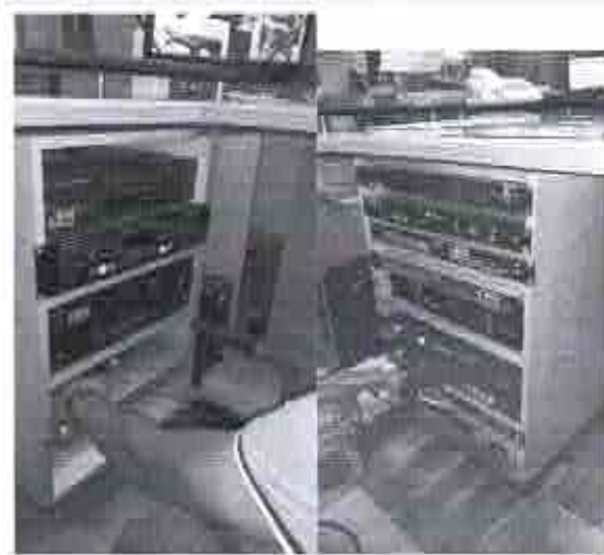
Limpeza de los equipos reproductores, amplificadores, distribuidores de audio, sintonizador y switch en cabina de transmisión
